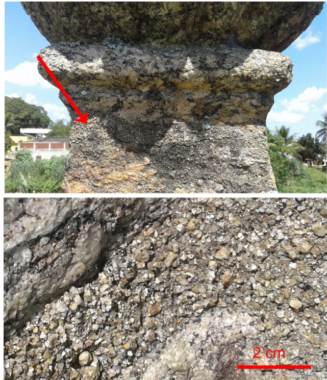
Figura 31 – No topo, marca de ruptura em coluna situada à esquerda do dístico. Abaixo, detalhe do cimento utilizado no restauro. Fotografia da autora (2018).
