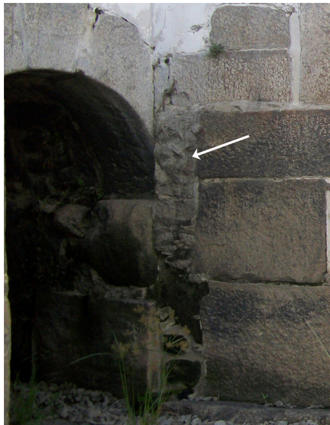
Figura 34 – Cantaria de arremate da junção entre parede e talhante. Fotografia da autora (2018).
