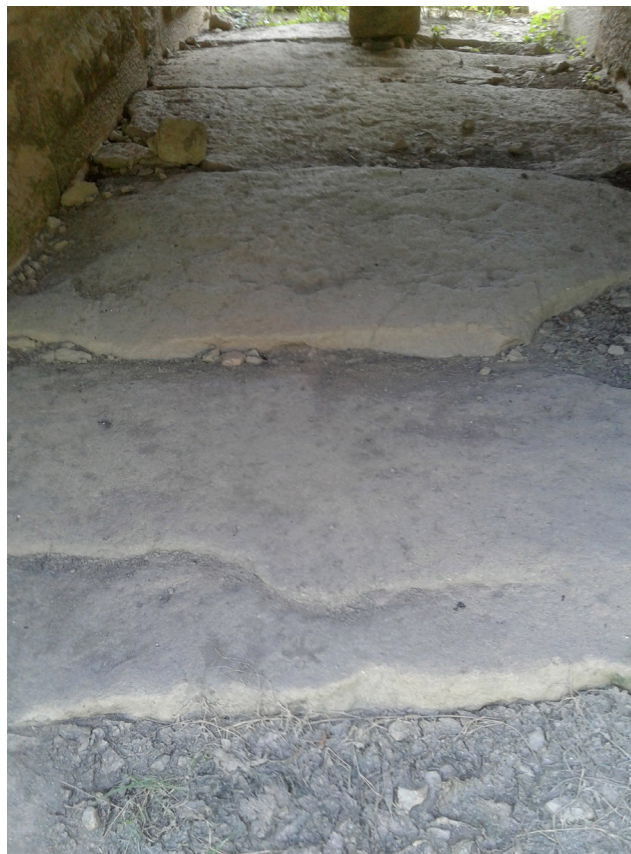
Figura 37 – Pavimento em lajes de cantaria no interior do túnel sul. Foto da autora (2018).
