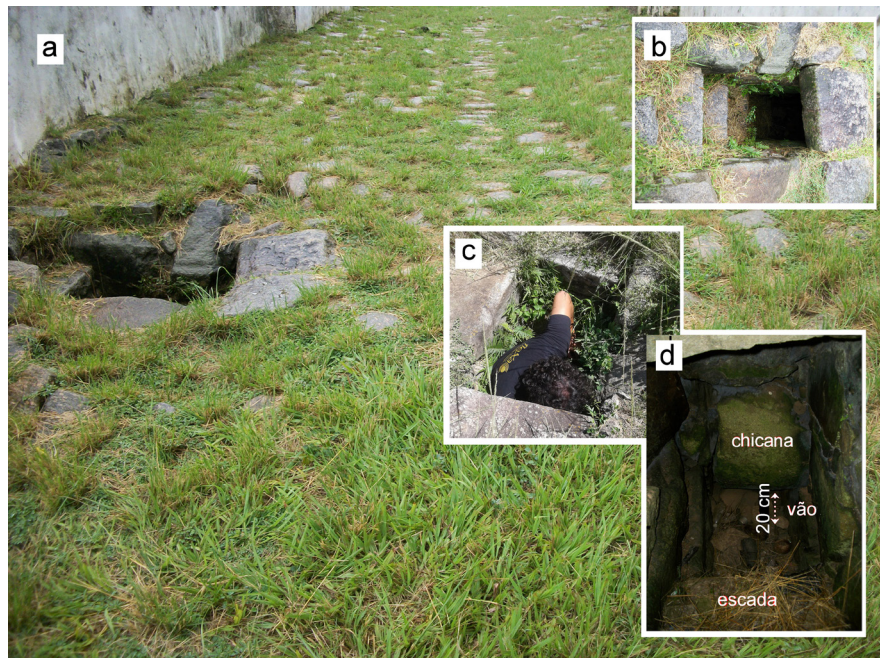
Figura 36 – (a) Abertura de acesso a vão sob o tabuleiro; (b, c) vista em planta da mesma abertura; (d) vista interna. Foto da autora (2018).
