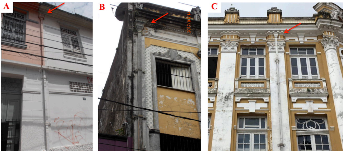
Figura 10 – Fachadas apresentando estudos de cores que não valorizam os dutos verticais, reduzindo o destaque e dificultando a sua leitura. Fonte: Fotografias das autoras.
