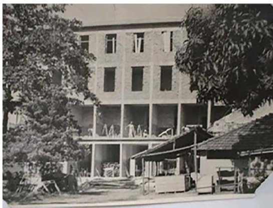
Figura 5a - Hospital do Centenário em construção, sem data. Fonte: Arquivo Público do Estado de Pernambuco.
