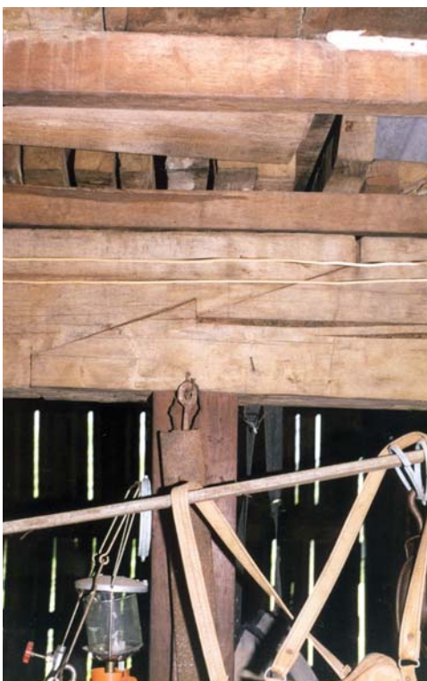
Figura 15 – Ensambladura kanawa-tsugi sem a utilização da cunha de compressão. O detalhe da foto apresenta baldrame e fundações em alvenaria de tijolos empregados na Igreja de Todos os Santos no bairro de Manga Larga, Registro. Fotografia do autor.
