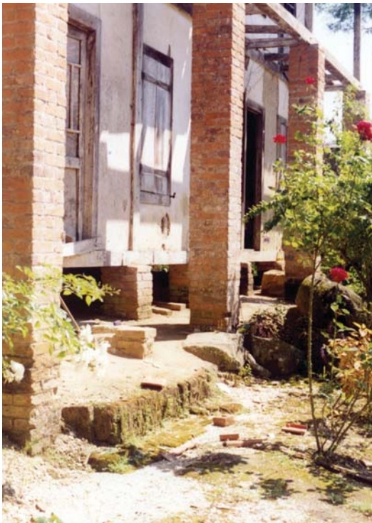
Figura 10 – Fundação em alvenaria de tijolo de barro da moradia da família Kiomi. Com seu apoio muito solapado, o detalhe apresenta a disposição da base da fundação, também em alvenaria. Fotografia do autor.
