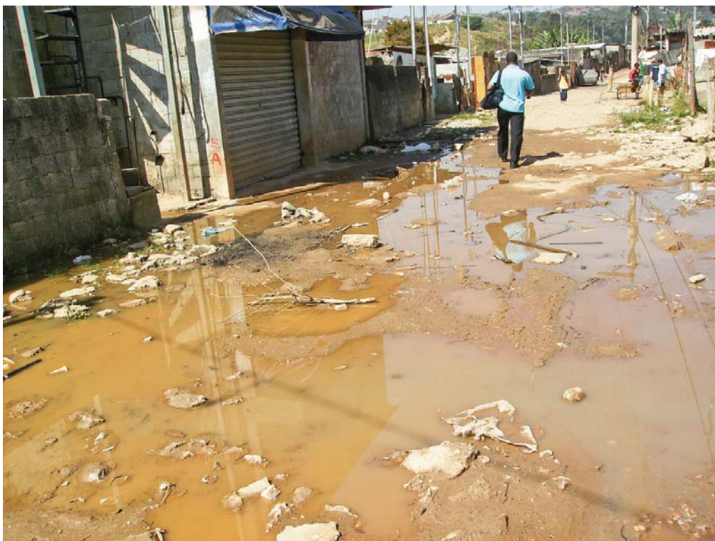
O esgoto a céu aberto traz mau cheiro e risco à saúde dos moradores do Jardim Maravilha.
