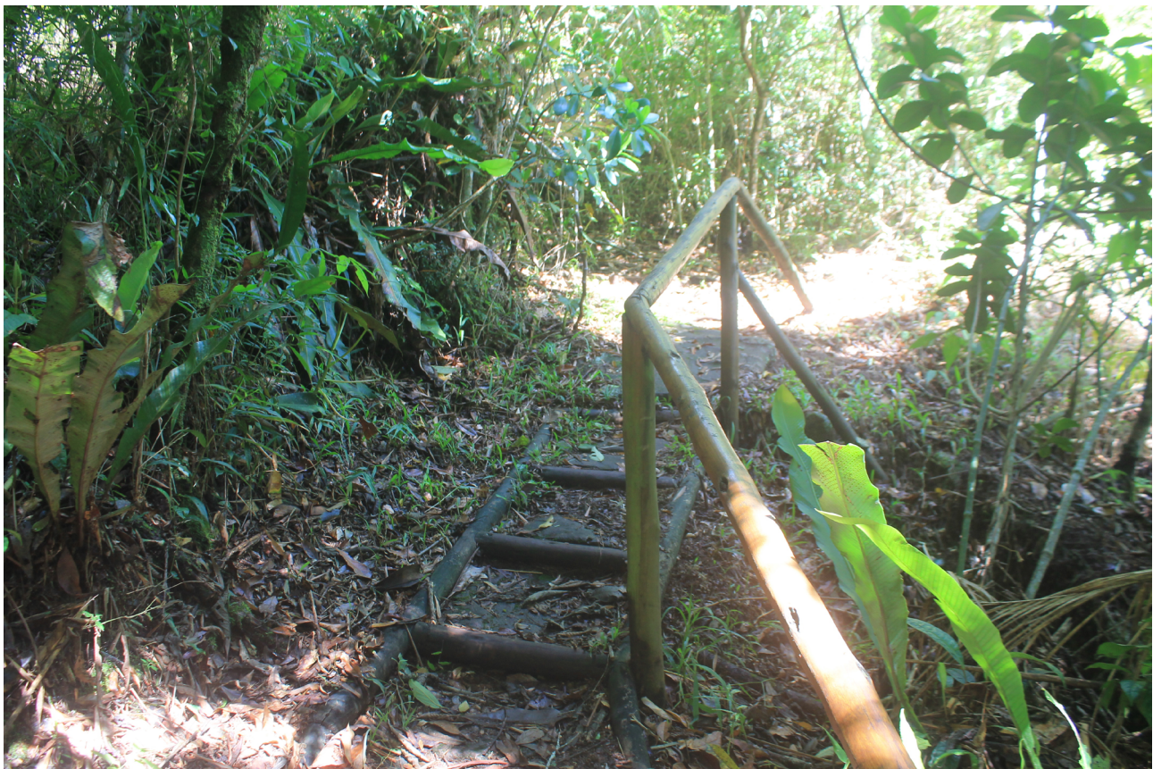
Figura 10. Exemplo da utilização de longarinas para minimizar os danos causados por erosão hídrica na trilha do Parque Estadual Forno Grande.
