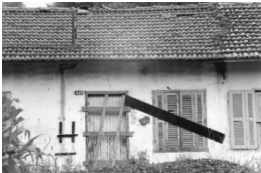
Votorantim, São Paulo Demolições na Vila Santa Helena, criada pela Fábrica de Cimento Votorantim, 2003
