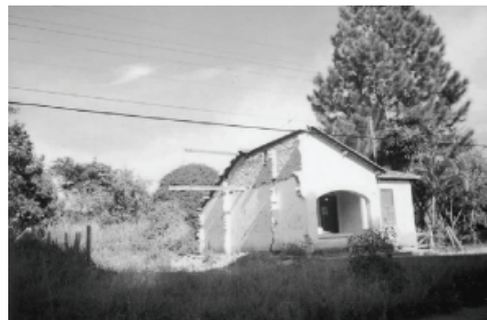
Pindamonhangaba, São Paulo Demolições no núcleo residencial criado pela Companhia Agrícola e Industrial Cícero Prado, 2001
