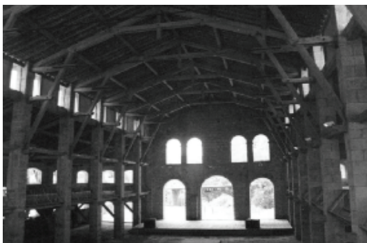
Iperó, São Paulo Prédios fabris da Real Fábrica de Ferro de São João de Ipanema, 2001
