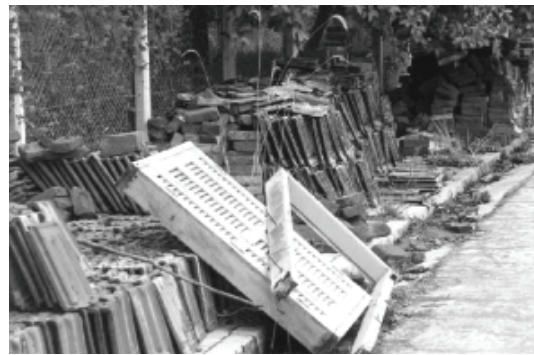
Votorantim, São Paulo Demolições na Vila Santa Helena, criada pela Fábrica de Cimento Votorantim, 2003
