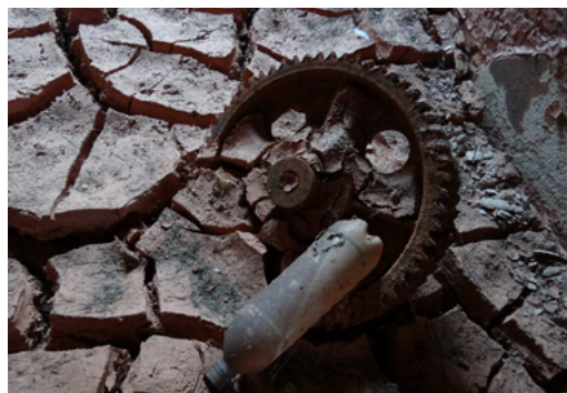
Fig. 13. Engrenagem localizada dentro do corredor do caixão alimentador.
