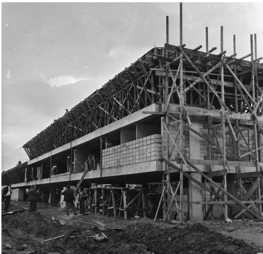
Figura 4 (topo): Fotografia do canteiro de obras dos primeiros blocos do conjunto. Fonte: Acervo Iconográfico do Arquivo Público do Estado de São Paulo, 1971.
